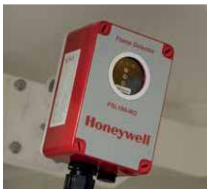
Rilevatore fiamma Flame detector
