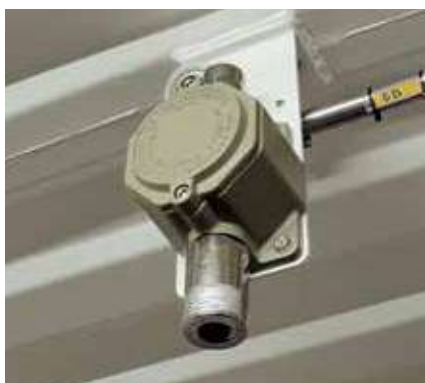
Rilevatore fughe gas Gas detector
