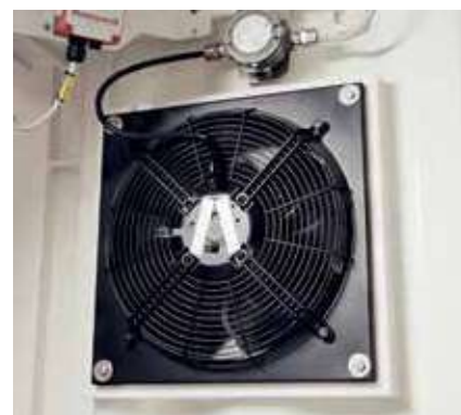
Sistema di ventilazione Ventilation system
