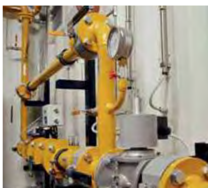
Linea di misura Metering system
