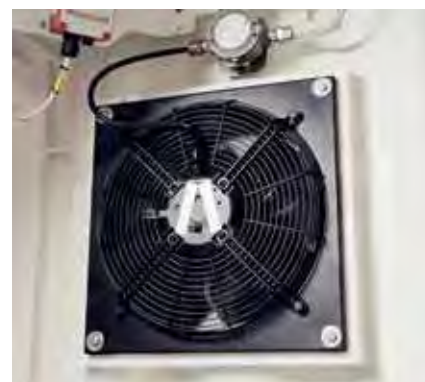
Sistema di ventilazione Ventilation system
